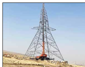
نقش اقتصاد - کرمانشاه - زینب ویسی: پروژه احداث خط ۲۳۰ کیلوولت سرپل ذهاب که حد فاصل پست ۲۳۰ کیلوولت و ۴۰۰ کیلوولت سرپل ذهاب قرار دارد، یکی از پروژه های مهم شرکت برق غرب می باشد که هدفش تقویت زیر ساخت صادرات، رفع افت ولتاژ پست ۲۳۰ سرپل ذهاب، افزایش قابلیت اطمینان و تقویت شبکه برق سامانه گرمسیری می باشد. الفتی نیا مدیر عامل شرکت در تشریح مشخصات فنی این پروژه گفت: پروژه احداث خط پست ۲۳۰ کیلوولت سرپل ذهاب به طول ۱۶ کیلومتر اجراء می گردد. در این پروژه تعداد ۵۷ برج فلزی مورد استفاده قرار خواهد گرفت. مدیر عامل شرکت برق غرب، پیشرفت کلی پروژه را ۶۰ درصد و ارزش روز سرمایه گذاری این پروژه را بیش از ۲۰۰۰ میلیارد ریال برآورد نمود.
